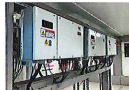
Les onduleurs dans le local technique de Raymond Vial sont reliés et informent en temps réel du fonctionnement des panneaux.
